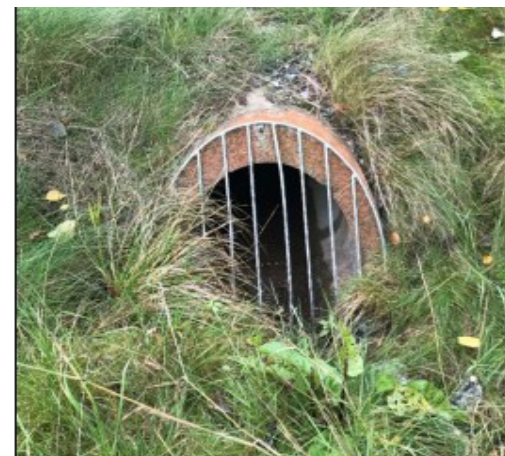
Gallerförsedd trumma under Kaxbergsvägen och vidare till Linabäcken
