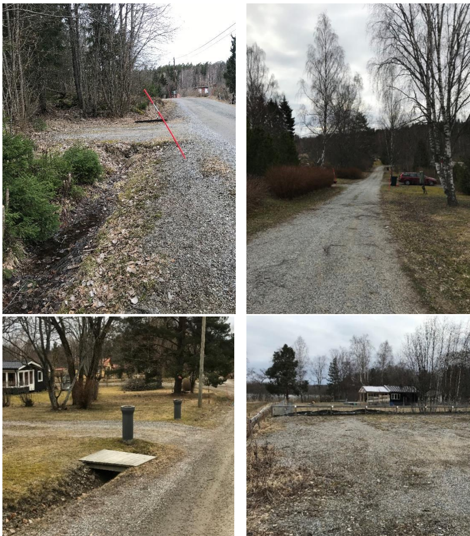
Figur 4. Stående vatten i dike framför tomt Stadvägen (övre t.v.), Sommarstigen (övre t.h.), infart till tomt över dike (nedre t.v.) längs Vårstigen samt parkering i Stadan (nedre t.h.).
