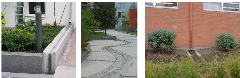
Figur 11. Bilderna ger exempel på stuprörsutkastare som ansluter till rännor samt olika typer av rännor.
