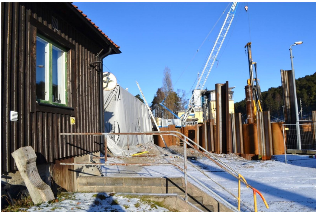
Den östra byggnadens östra fasad med nedgång till källaren. Den norra byggnadens gavel inklädd i plast syns i bakgrunden tillsammans med grundläggningen för den nya bron.
