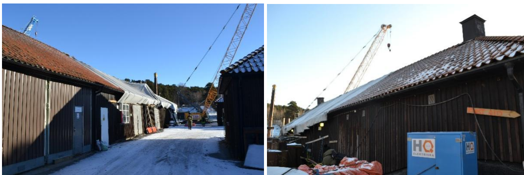
Den norra byggnadens södra långvägg (bild t.v.) och den norra långväggen (bild t.h.). Norra fasaden är under inventeringstillfället stämpad och täckt med ett plastskynde då byggnaden börjat rasa i samband med att pålning för brofästet uppfördes. I förgrunden av bilden t.v. syns den tillbyggda delen av norra byggnaden som innehåller garage.
