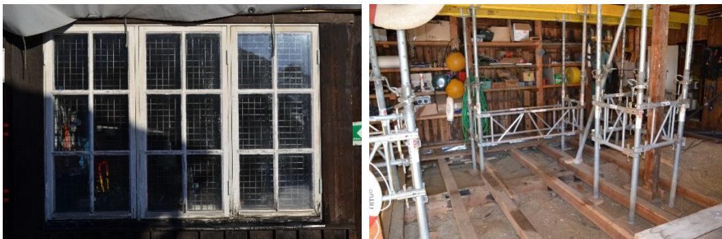
Ett av de äldre fönstren på norra byggnaden. Jämför med fönster på inventeringsbilderna från 1970-talet. Ytterbågen på de äldre fönstren på norra byggnaden är däremot troligtvis senare utbytta då den är av annan (sämre) kvalitet i träet med aluminiumlist nedtill jämfört med det äldre fönstret på östra byggnaden vilka också har äldre utanpåliggande spetsiga gångjärn.
