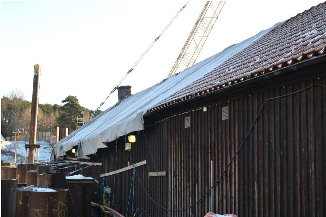
Förstärkning av den norra byggnaden utvändigt då byggnaden satt sig i samband med byggandet av bron.
