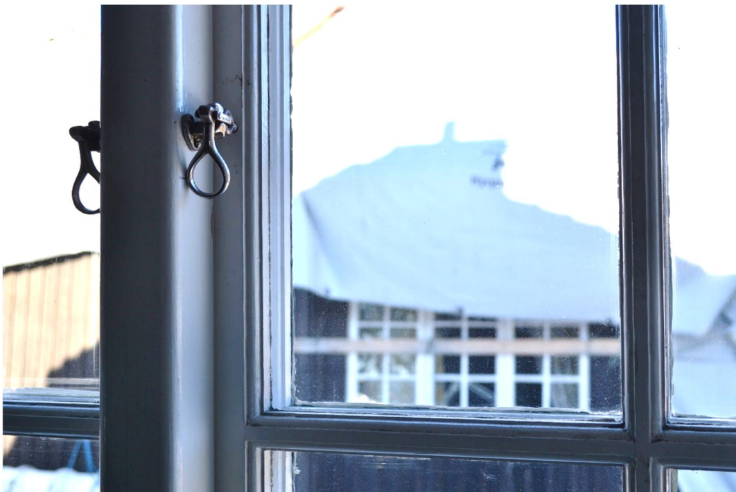
Detalj av spröjsat fönster, på den östra byggnadens norra gavel, inifrån personalrummet.
