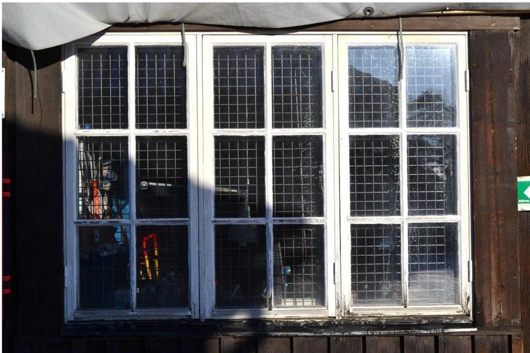
Fönster av äldre typ, troligtvis original, men med utbytta delar och tillägg i form av aluminiumlist.
