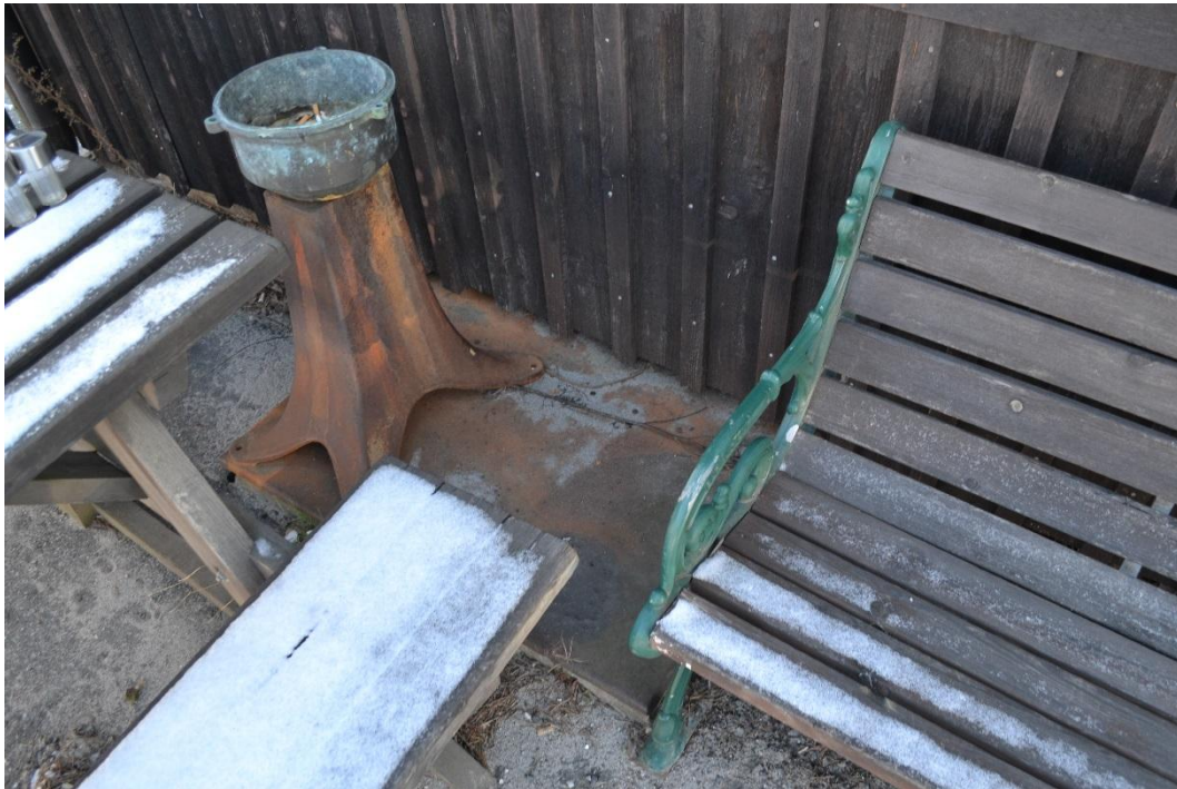
Tidigare nedkast för kol ner till värmeanläggningen i källaren. Nu igensatt.
