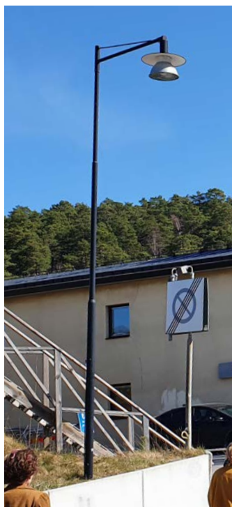
Stadens armatur vägbelysning
