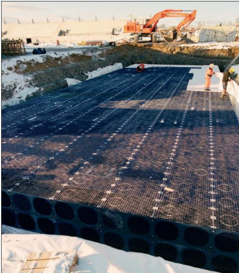
Figur 12. Exempel på fördröjningsmagasin i form av dagvattenkassetter, foto: Wavin
