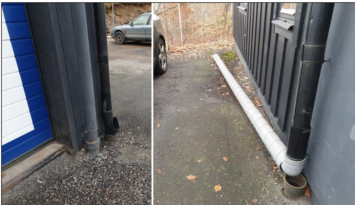
Figur 9. Anslutet och bortkopplat stuprör på verkstadsbyggnad
