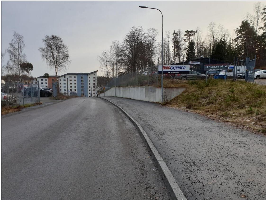
Figur 3. L-stödmur längs Viksängsvägen. Planområdet till höger i bild (Foto: Norconsult)
