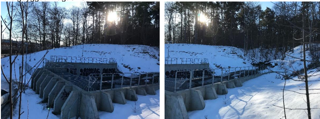
Figur 20. Bilder på befintligt fördröjningsmagasin (Bild från platsbesök 2019-02-12).
