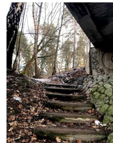
Betongbroar med klotter kan ge ett skräpigt och otryggt intryck.
