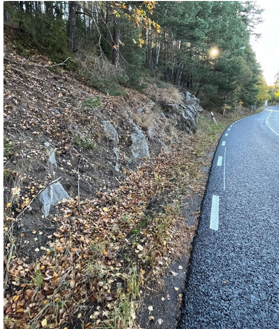
Bild 9: Avsaknad av dike nära slänter
