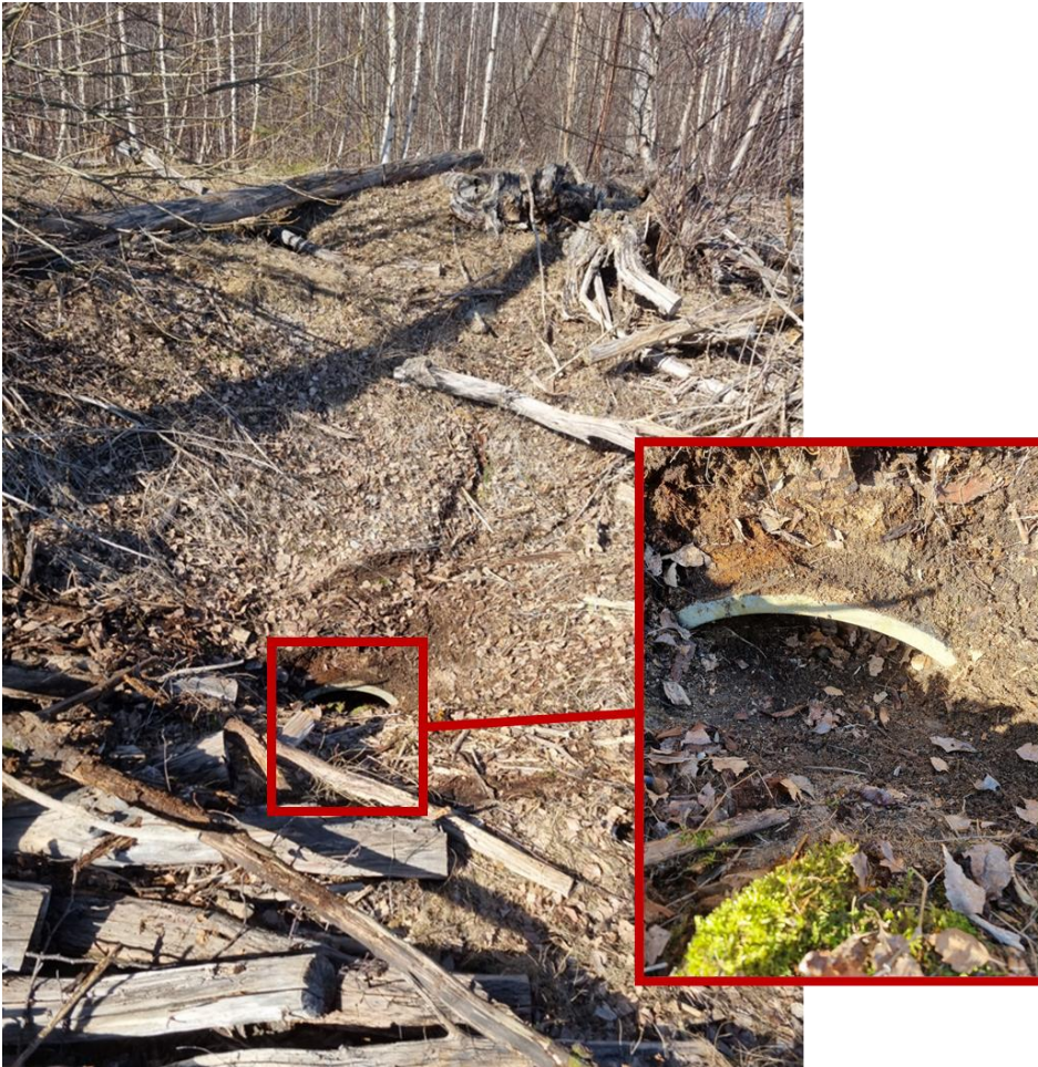
Figur 5-3: Befintlig järnvägstrumma under stambanan som är igensatt med sediment.
