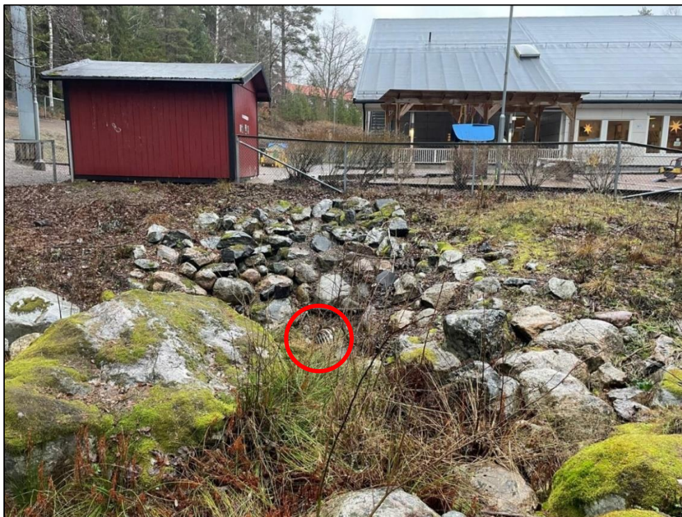
Figur 17. Foto på befintligt rör vid förskola (Erhållet av Södertälje kommun 2024-12-19).
