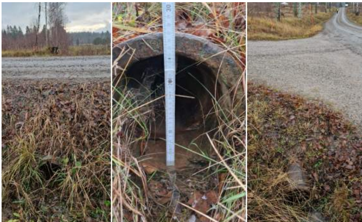
Figur 8. Observerade trummor vid platsbesök den 5 december 2025.
