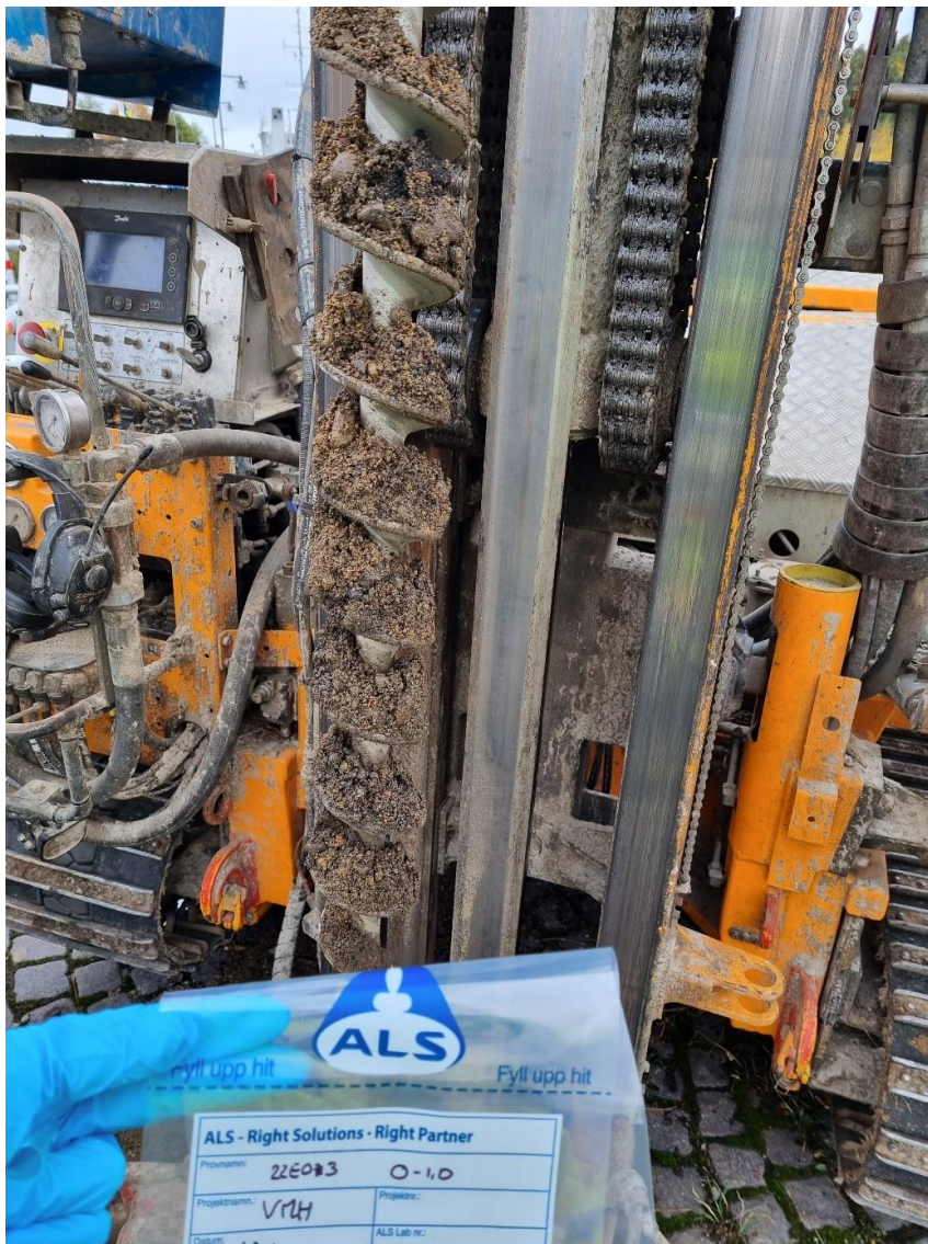
Figur 9. Skruvborr tagen från den södra delen av kajen.
