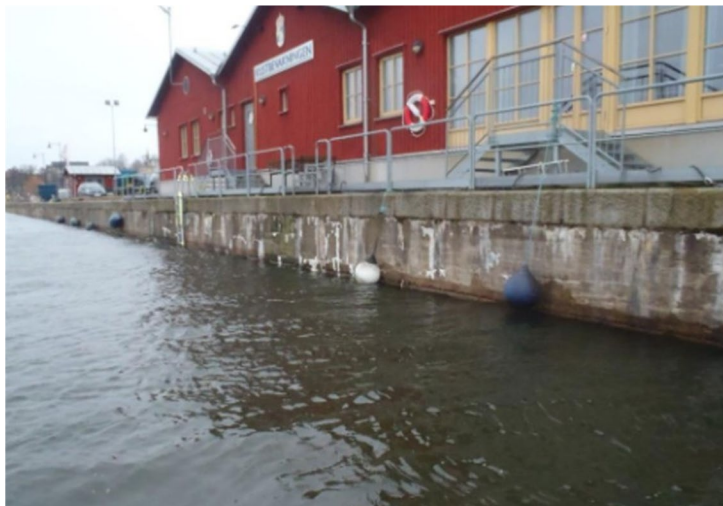
Figur 6. Kustbevakningens stationsbyggnad är placerad nära kajkanten, vilket försvårar både underhåll och renovering av kajen utan att byggnaden flyttas.
