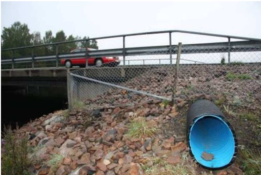
Bild 2. Felaktigt anlagd torrtrumma i kombination med ett ledande finmaskigt stängsel. Notera att stängslet borde ha placerats närmre vägbanan för att undvika en glipa i stängslet i anslutning till torrtrumman. Foto: Mia Bisther
