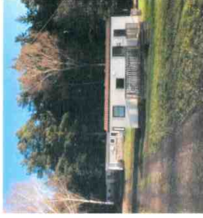
Campingstugor i behov av underhåll.
