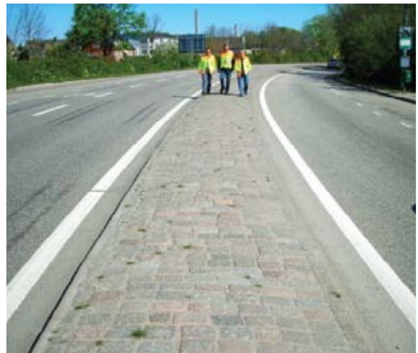
Bild 29. Kalkbrottsgatan november 2007, ett halvår efter fogning.
