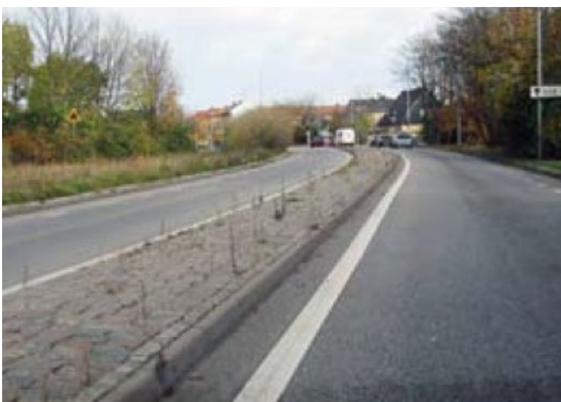
Bild 30. Kalkbrottsgatan november 2007, cirka 1 år efter fogning.
